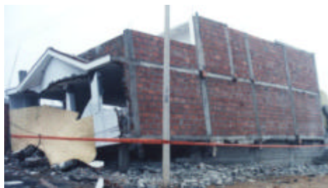
Figura 5. Vivienda colapsada por tener poca densidad de muros en la dirección de la fachada; sismo del 23 de junio del 2001 en el sur del Perú
