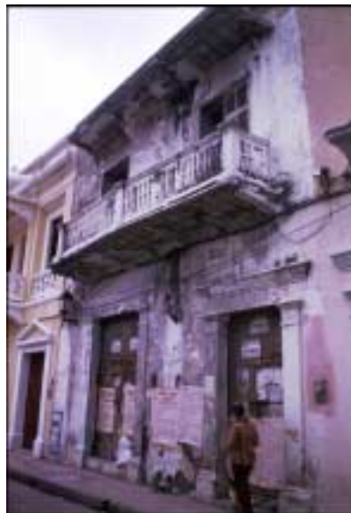
Figura 1 – Daños de deterioro evidente en una edificación. Cada manifestación de daño tiene su naturaleza la cual debe investigarse con conocimientos y responsabilidad.
