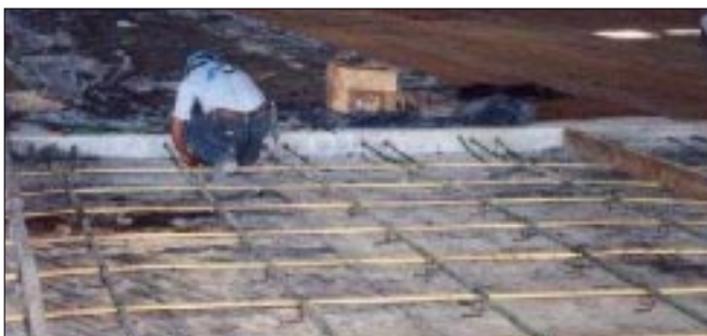
Se aprecia el recubrimiento de los torones con polietileno y la ausencia de refuerzo convencional
