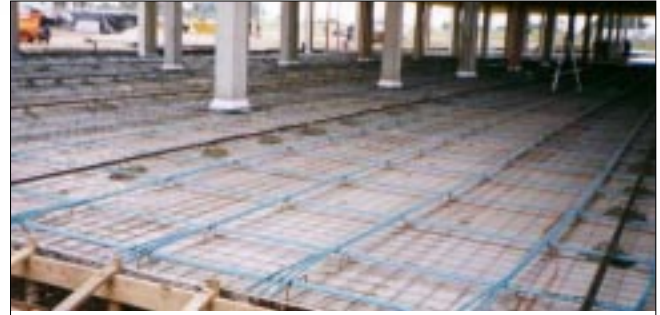
Detalle de la distribución de cables sobre el piso
