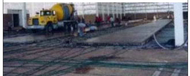
Detalle de un piso fundido por bandas intercaladas. Las juntas de construcción se cierran en el momento en que los cables son postensados
