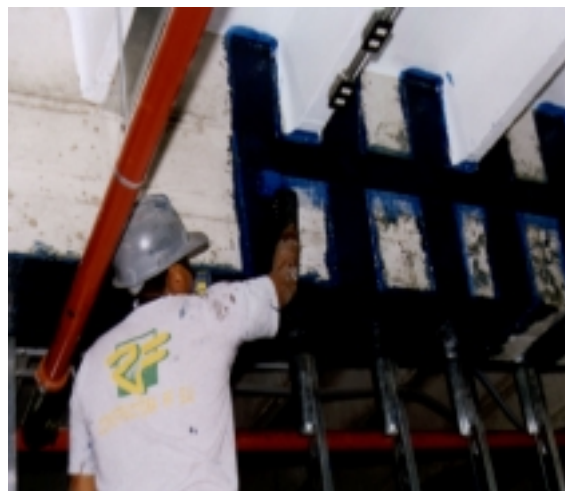
FOTO 02: Reforzamiento por corte y flexión de viga estructural en Edificio Chocavento – San Isidro
